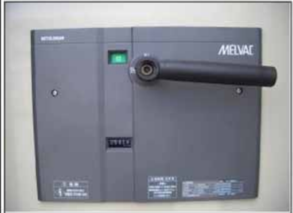
真空遮断器 (VCB)
