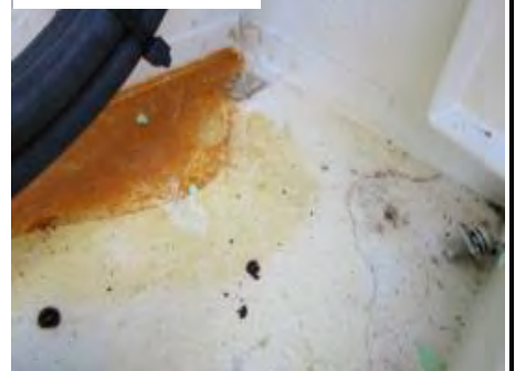
浸水した痕跡
