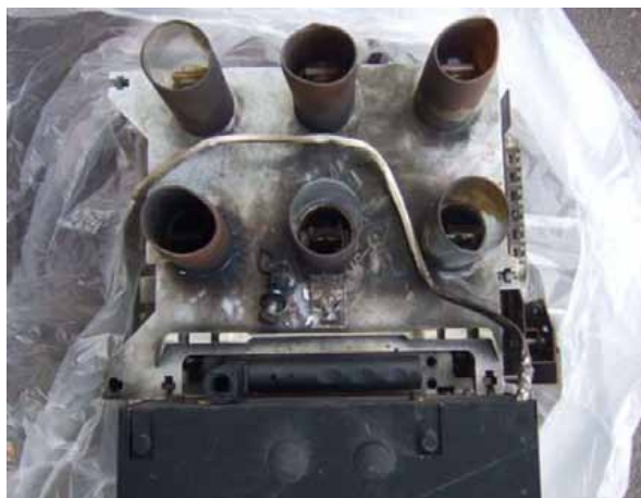
損傷したVCB
