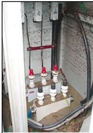
キュービクル(内部)
