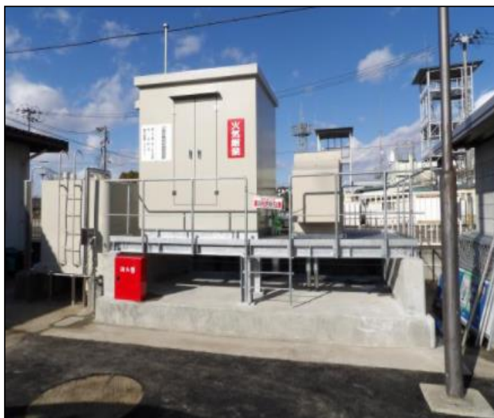
非常用発電設備
